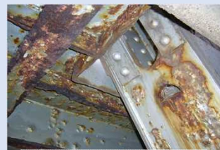
支柱のさびが進行
