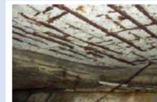
塩害により鉄筋がむき出し
