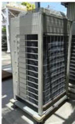
(熱交換器側より)
