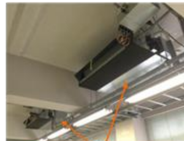
ダクト型 室内機(2.5HP) × 2台
