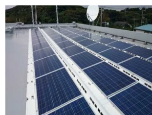
小型太陽光発電所(小学校屋上)
