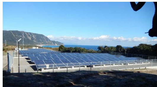
大原太陽光発電所(315kW)
