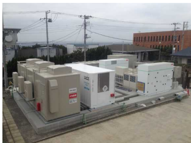
発電所内の系統用蓄電池(1,000kWh)
