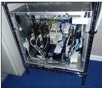
SCADA/総発電計測装置
