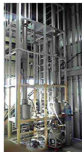
図Ⅲ-2-(イ)-C-1(6) 精留塔
