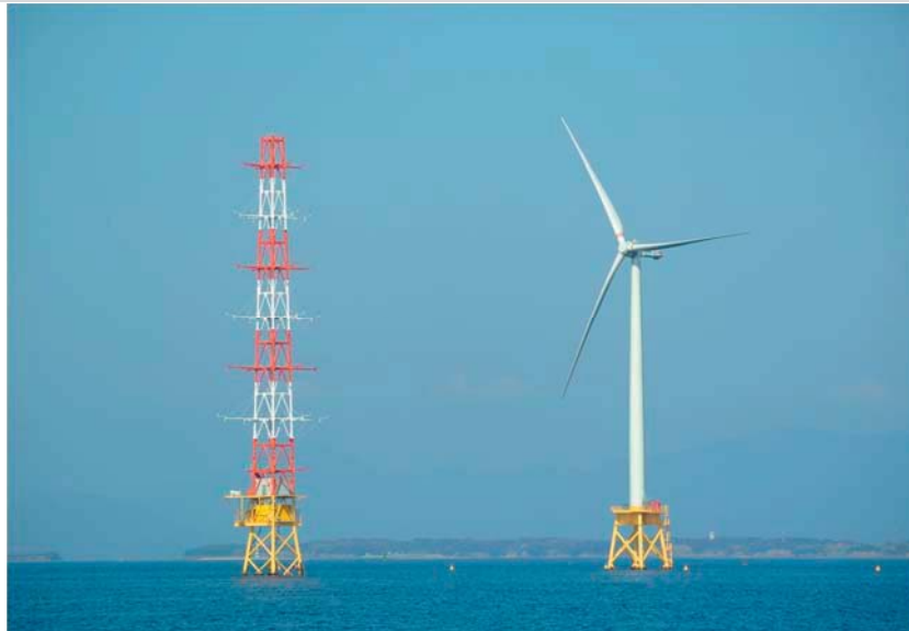
図 2.3.2-6 着床式洋上風力発電実証研究施設(北九州市沖)
