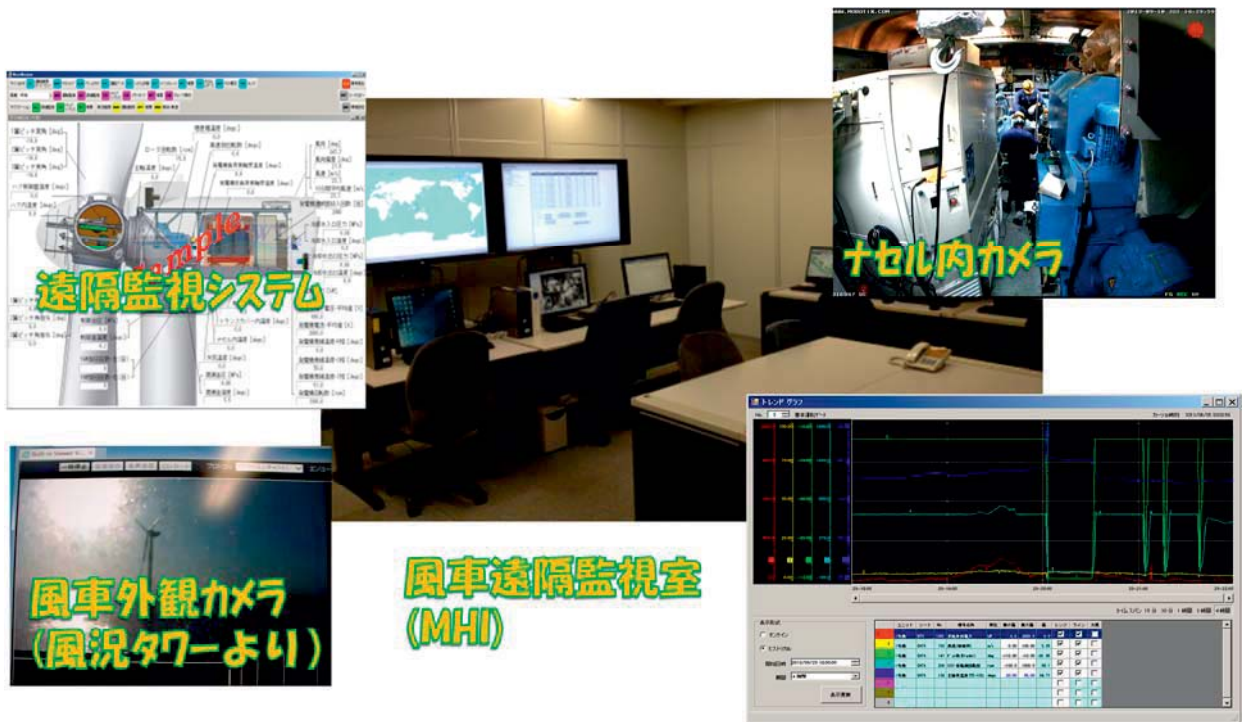
図 3.8.3-4 風車遠隔監視室からの運転監視状況(東京電力・東京大学資料)
