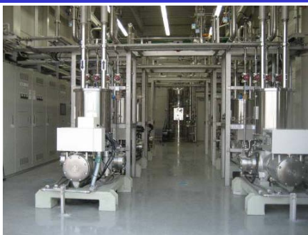
冷却システム外観
