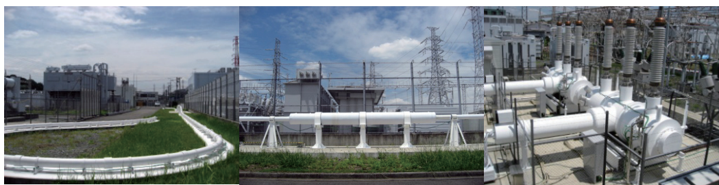
超電導電力ケーブル管路
