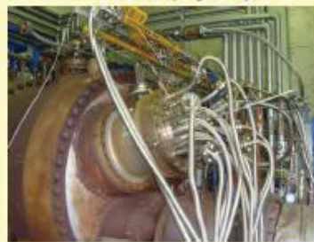
高圧試験装置
