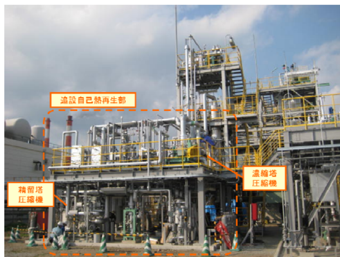
写真 III-2-2-7. 自己熱再生型酵素回収蒸留設備（呉）
