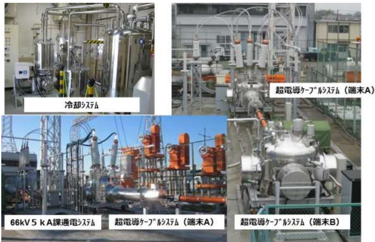
図 2.2.2-4 15 m 長 検証試験ケーブルシステム写真
