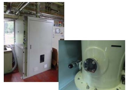
安全な試験のためのHF除害装置
