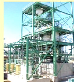
ホタル石の回収設備
