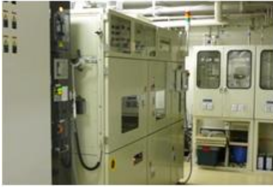
図Ⅲ-2-(イ)-A-1(3) 常圧 CVD 装置
