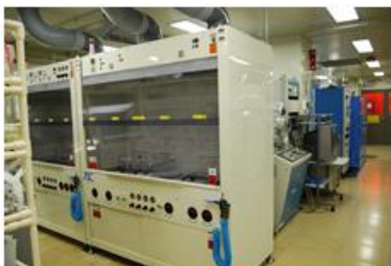
図Ⅲ-2-(イ)-A-1(1) 基板洗浄用ドラフト
