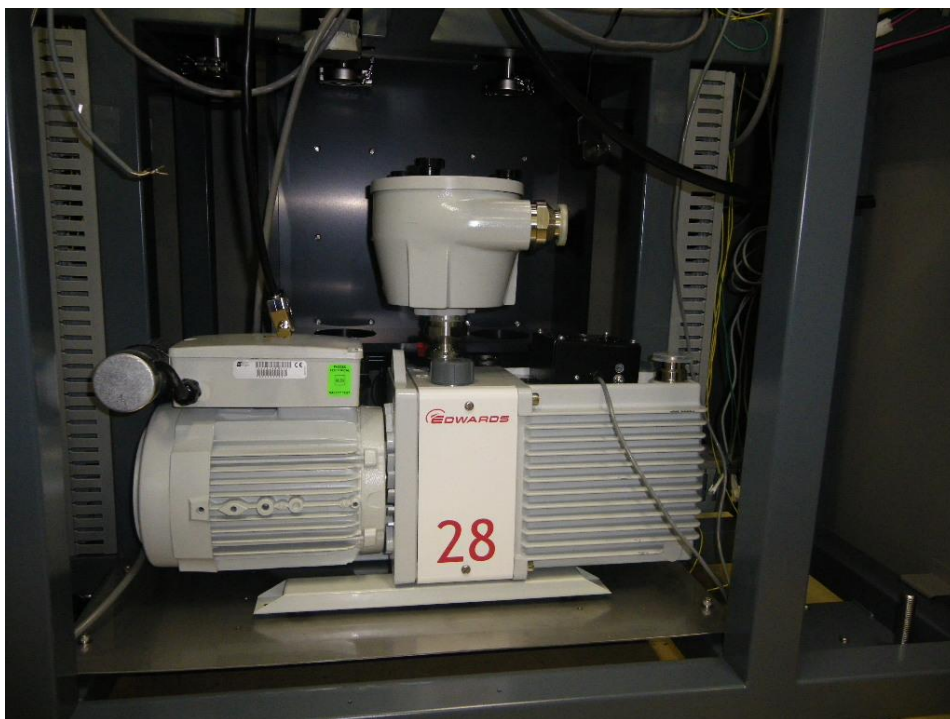
図Ⅲ-2.18.10 粗排気用ロータリベーンポンプ
