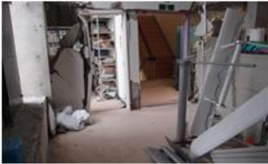
(a)被災した建物内部
