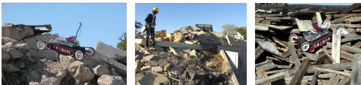
(d) 鉄筋コンクリート瓦礫 1 (e) 鉄筋コンクリート瓦礫 1 (f) 木造瓦礫 (10mのみ)
