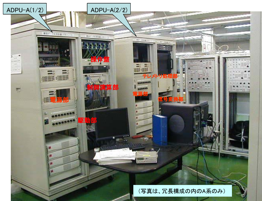
図 3. 2. 3. 5-6 機体データ処理装置の試験状況写真
