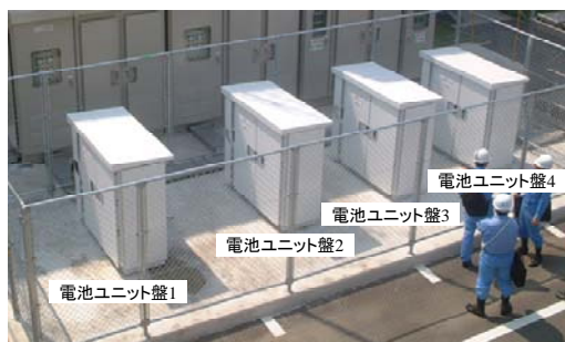
図5 33kWh級ユニット(4台)
