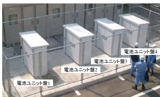
図5 33kWh級ユニット(4台)
