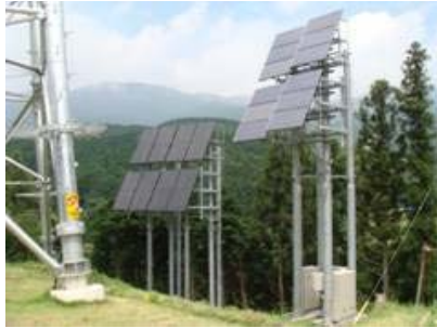
図10 太陽光発電設備(福岡県筑紫野市)
