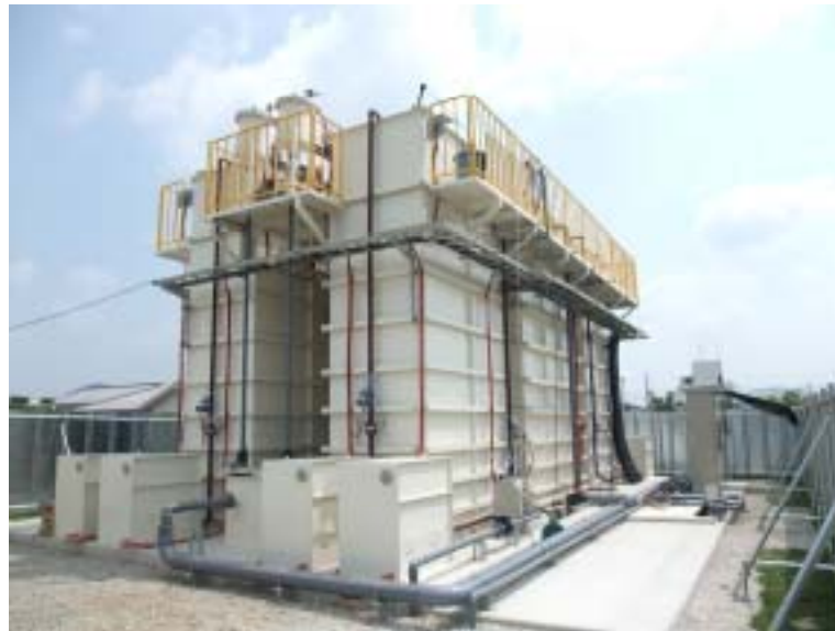
福島浄化センターに設置した パイロット試験装置
