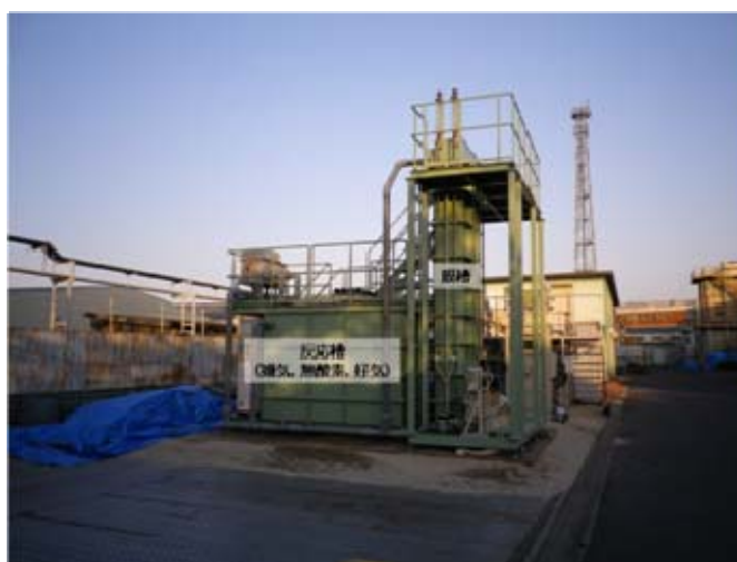
図Ⅱ.3.1-1 省エネ型MBRパイロットシステムの外観
