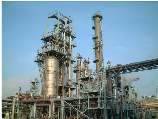
JXエネルギー川崎工場 IPA製造装置
