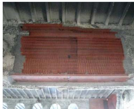
剥離後の状況
