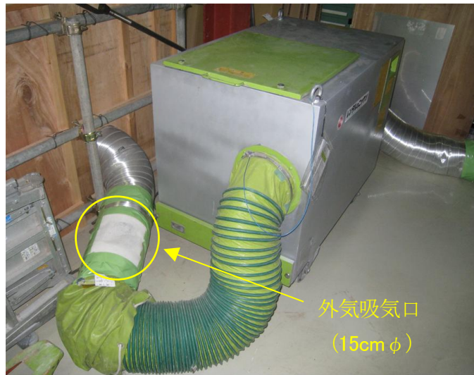
図 5.3-12 集塵機ダクト部の外気吸気口
