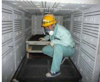
バッチ式炉の内部
