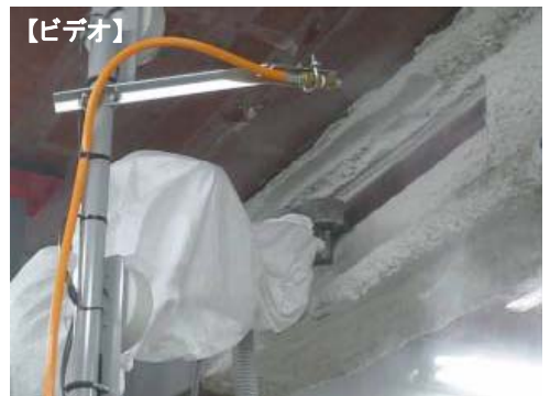
梁部 (t40~50mm) 剥離実験
