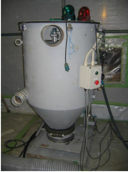
写真 7-17 回収・袋詰装置 (清掃後)
