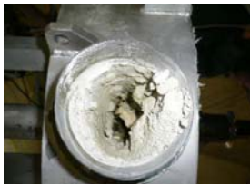
ダクト閉塞状況
