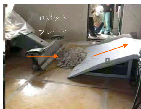
写真4-2 移載装置 (ロボット操作時)
