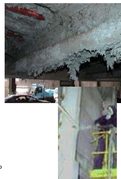
吹付けアスベスト
