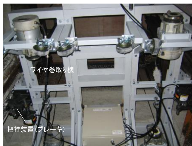
写真 3-8 昇降ゴンドラ架台装置（見上げ）
