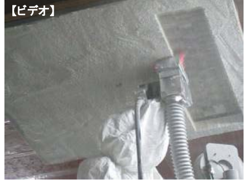
天井部 (t20~25mm) 剥離実験
