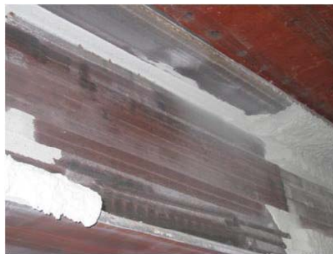
剥離後の状況
