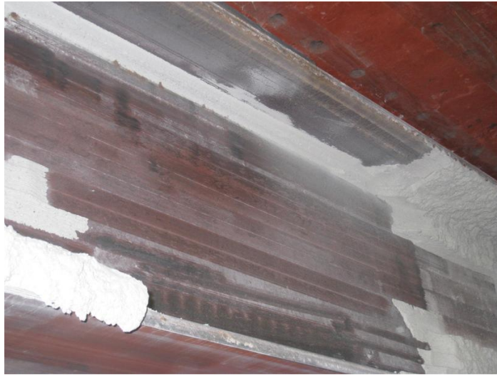
図 5.3-5 全面剥離後の状況
