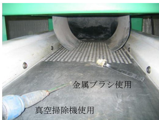
写真 7-13 破砕装置（清掃中）
