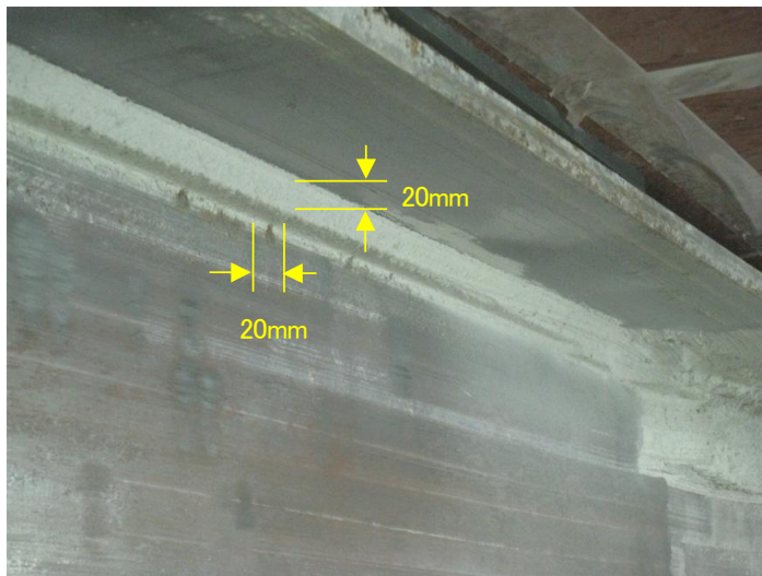
図 5.3-6 入隅部の剥離残り状況
