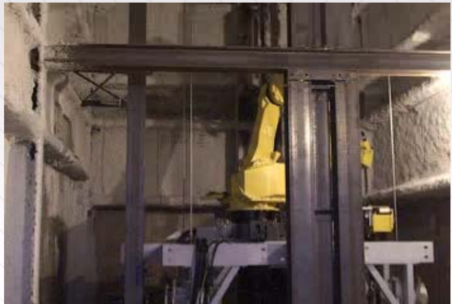
模擬エレベータシャフト内(自動除去運転)
