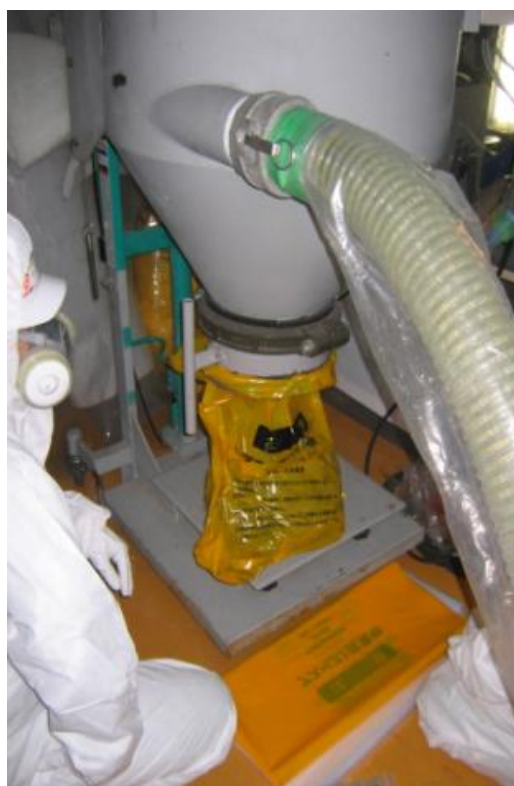
写真 4-6 回収・袋詰装置
