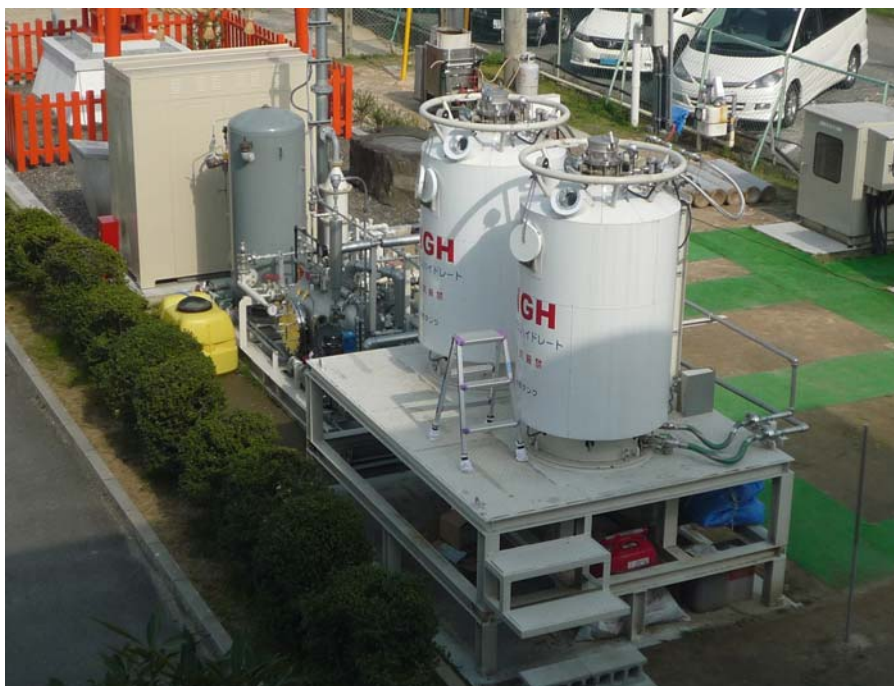
写真 2.2.2-2 小口需要家設備の全景写真
