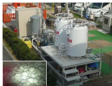
小口需要家設備
