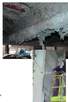
吹付けアスベスト
