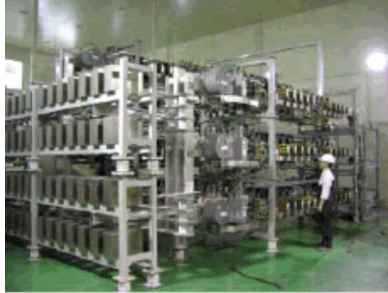
図表 9.60 Kangjin 変電所の UPFC
