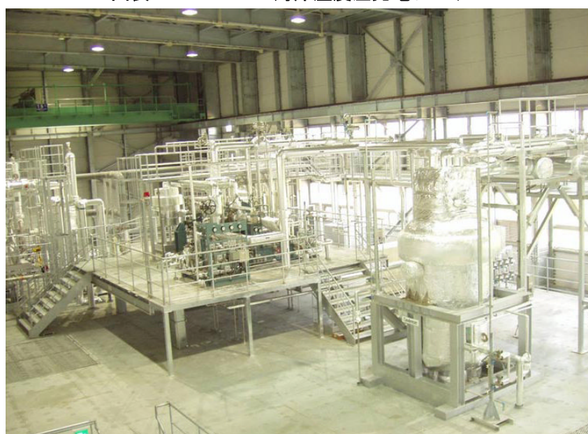
図表 7.20 30kW 海洋温度差発電システム
