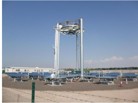
図表 5.52 ビームダウン型太陽熱発電システム（アブダビ実証試験サイト）
