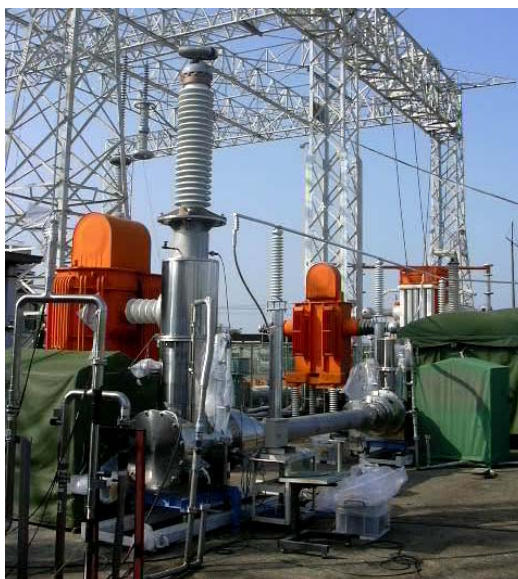
図 2. 1. 3-13 課電試験システム外観
