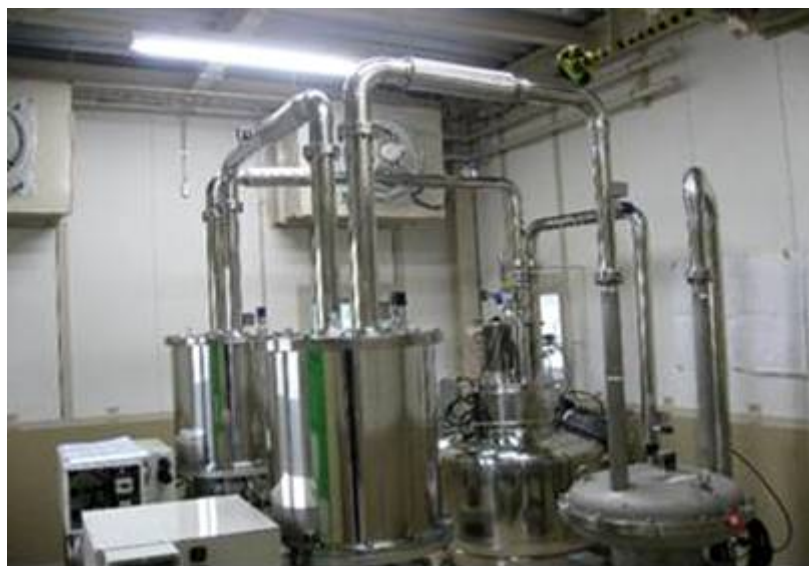
図 2.1.5-17 検証ケーブル用冷却システム
