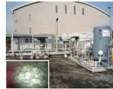
大口需要家設備
