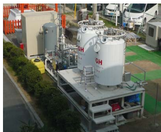
小口需要家設備
