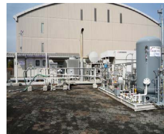
大口需要家設備
