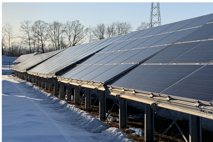
図 5-10 太陽光発電設備の凍上被害の一例
