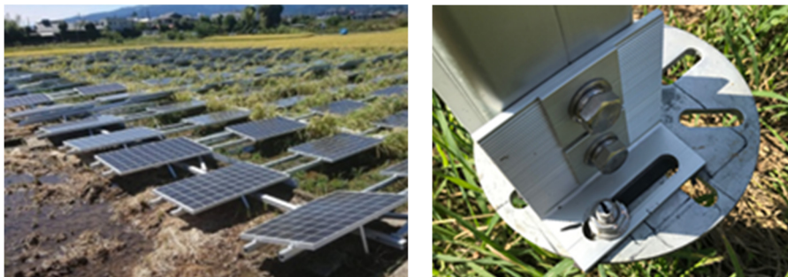
写真 2-1 営農型太陽光発電設備の強風被害事例（1）提供：事業者
