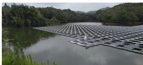
図 3-4 機器設置状況
