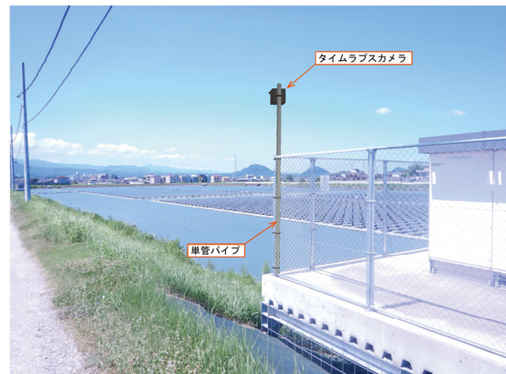
(d) 北側アイランド PCS 侵入防止フェンス
