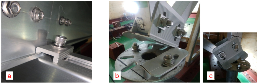
パネル受け材押え金具の緩み (1800 Pa)
