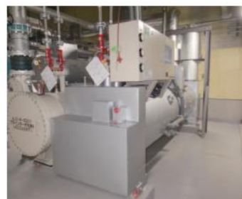
プリンターボ冷凍機
