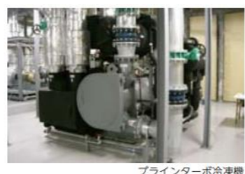
プリンターボ冷凍機
