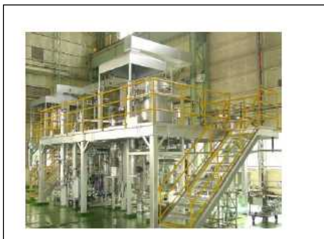
図 1-3-2バイオマスガス化試験設備
