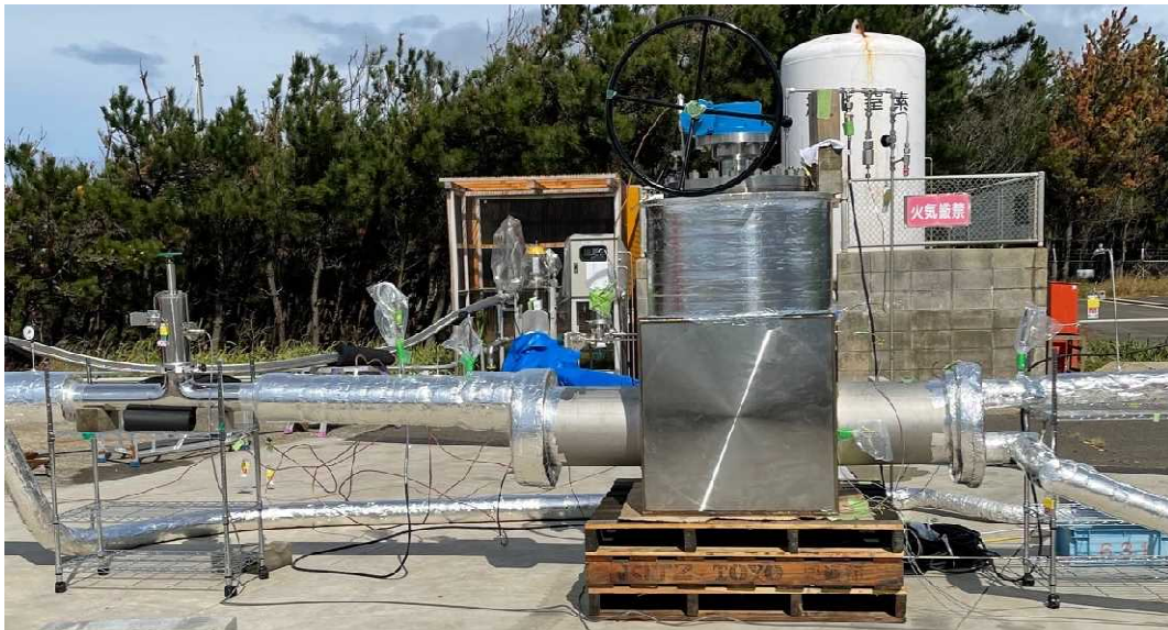
ボール弁 実流体試験状況
