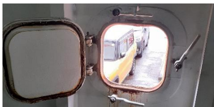
ケーブル送り出し窓 (陸側)
