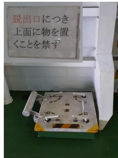
脱出口付近の床へ開口を設け、 ケーブルを下の階の機関室へ
