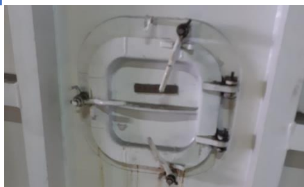
ケーブル送り出し窓 (海側)
