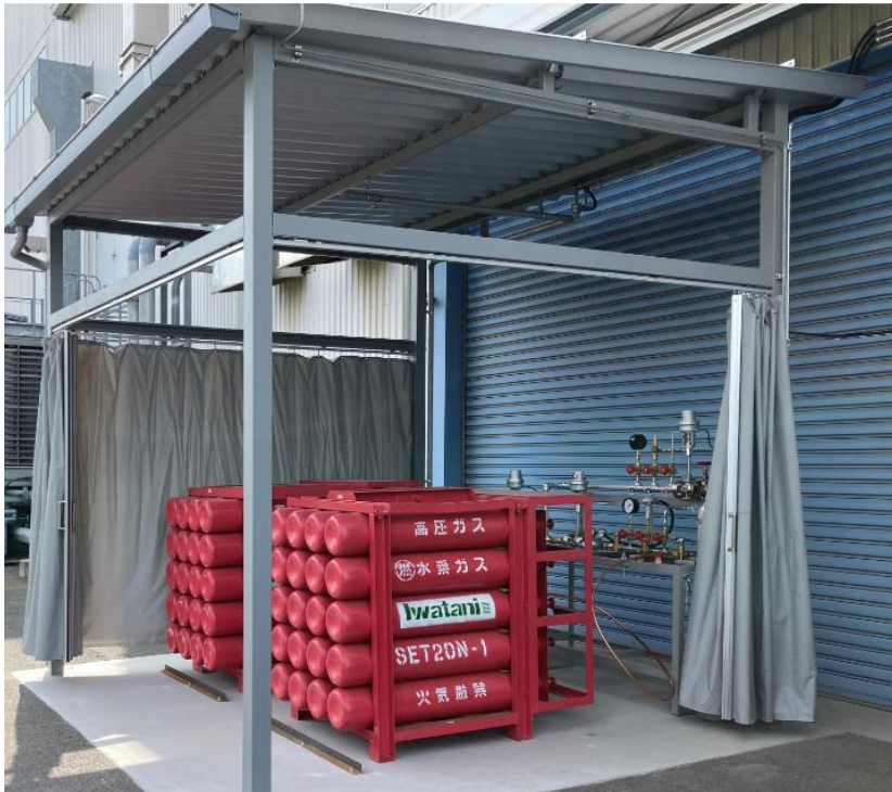
水素供給設備
