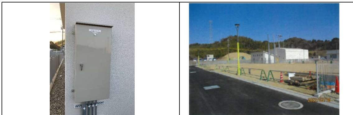
図 3.2.1.1-12 ①-7 その他(共用電源設備)
