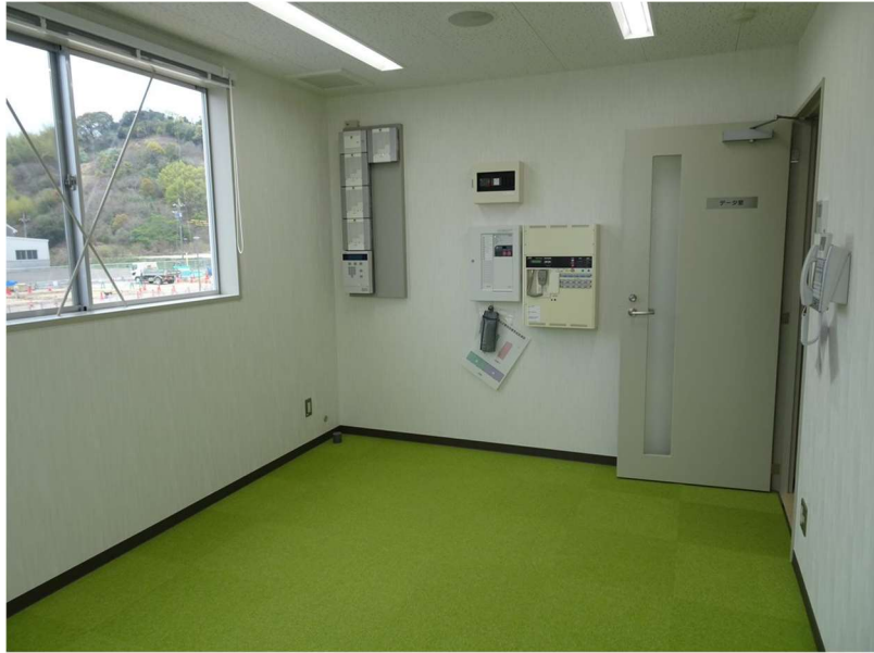
図 3.2.1.2-21 共用棟のデータ室内部(奥から入口方向)の竣工状況(2022年4月12日)
