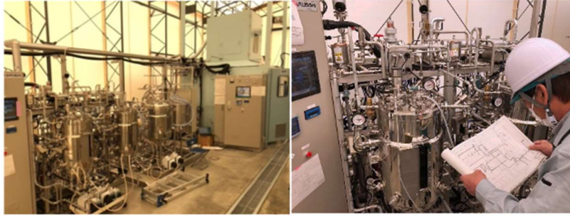
図 3.2.2.3-8 油脂発酵リアクターおよび試運転の様子
