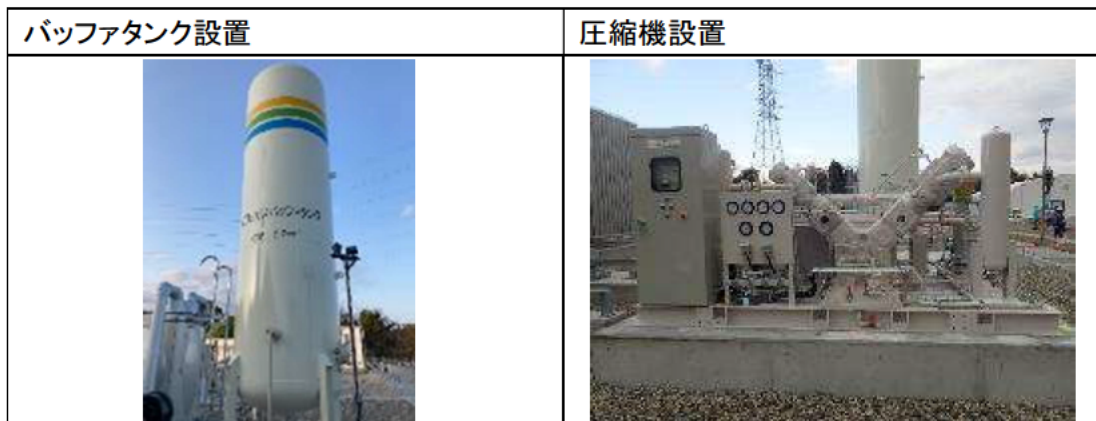
図 3.2.1.1-8 ①-2 CO 2 供給設備
