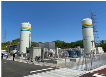
【A-1】CO 2 供給設備
