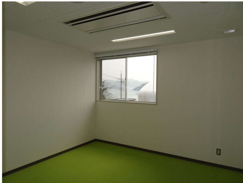
図 3.2.1.2-20 共用棟の小会議室内部(入口から奥方向)の竣工状況(2022年4月12日)
