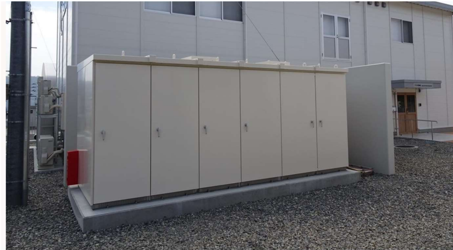
図 3.2.1.2-16 基礎研究・先導研究拠点のキュービクル(主電気設備)の竣工状況(2022年4月12日)
