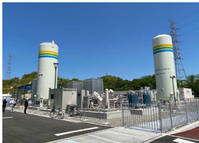
【A-1】CO 2 供給設備
