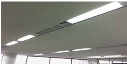
照明(LED)の間引き消灯を実施
