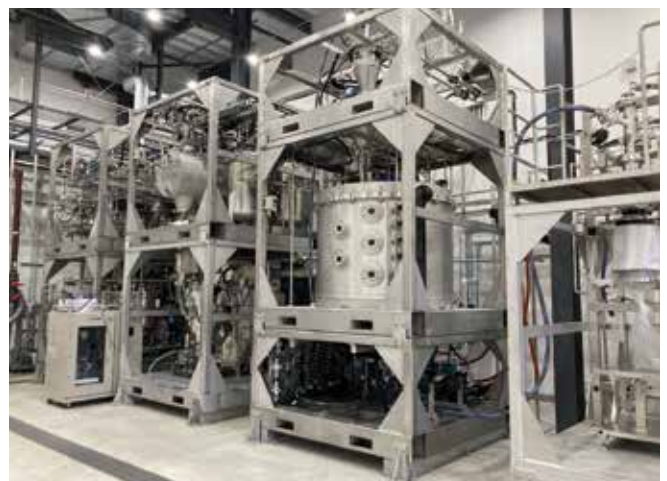
iFactoryの実証設備外観 提供 : (株)高砂ケミカル
