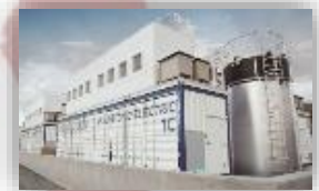
蓄電池の送電・配電併用運転実証（米国）
