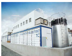
系統安定化のための蓄電池
