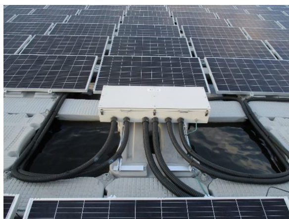
写真 12-3 接続箱の設置例
