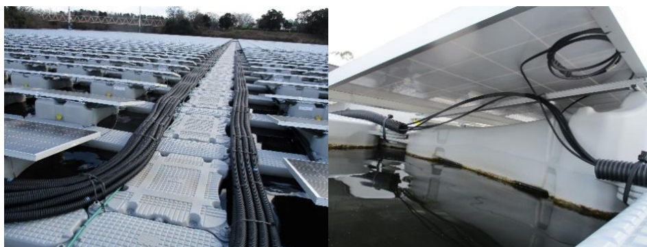
写真 12-2 配管に納めた配線の例
