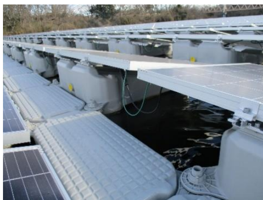
写真 12-1 余長を考慮した配線の例
