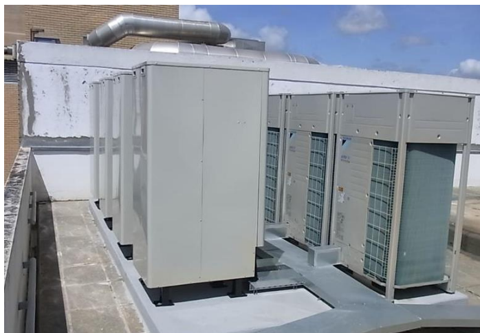
実証サイトに設置したVRV室外機と蓄冷ストレージ
