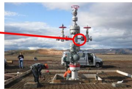
<IDDP-1 坑口装置全景>
