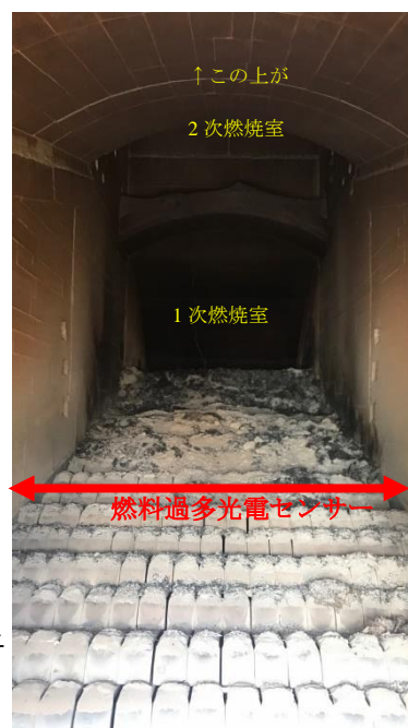
図 2.2.43 バイオマス熱風炉内部の様子
