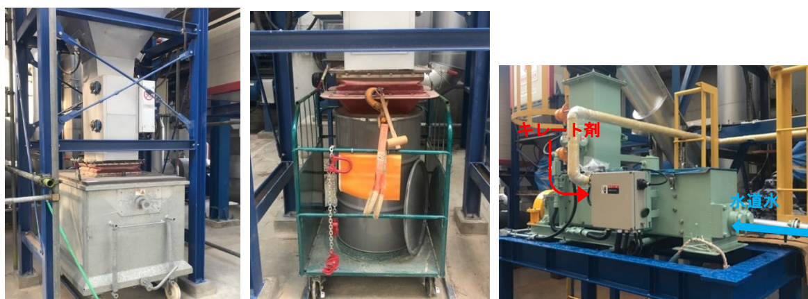
図 2.3.21 飛灰の回収に関する各種設備
