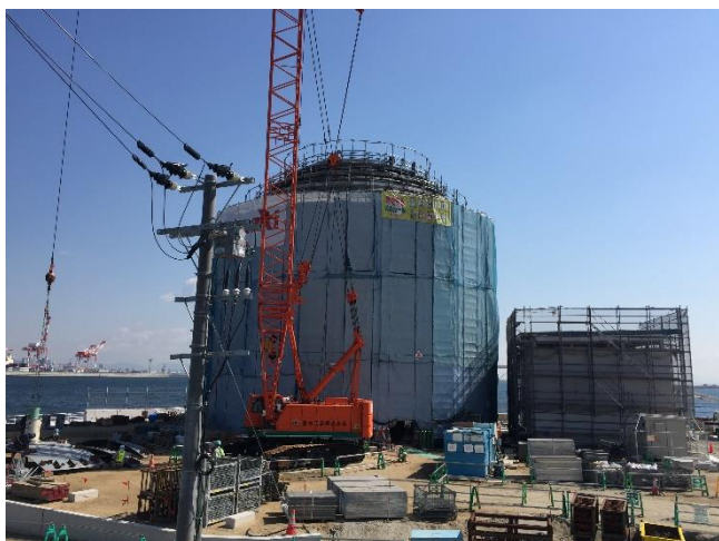
(a) 液化水素貯蔵タンク
