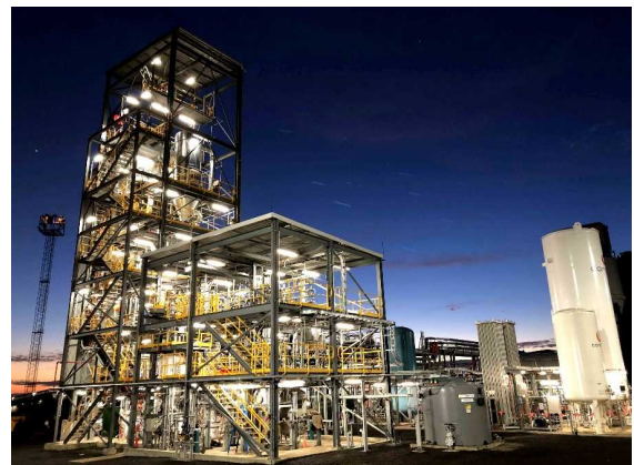
プラント全景 (2020.7.29撮影)
