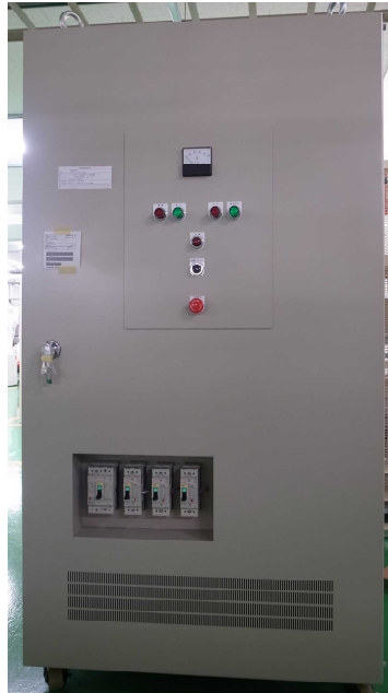
図 3-4-186 10kV 器用制御装置
