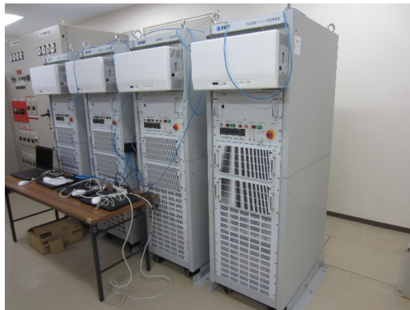
図 5.4(2)-8 低圧住宅用 PV 模擬電源装置
