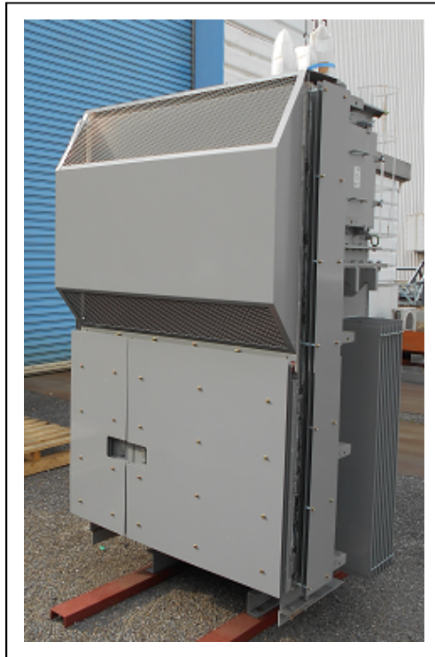
50Hz 試作機(300kVA, SiC 使用) (日射対策カバー改良後)
