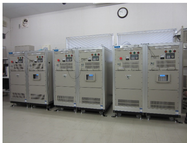
図 5.4(2)-3 20kW 級大規模 PV 模擬電源装置
