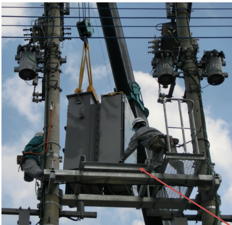
図 5.4(3)-3 次世代 TVR 設置状況
