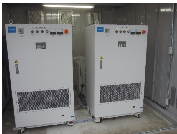
図 5.4(2)-2 100kW 級大規模 PV 模擬電源装置
