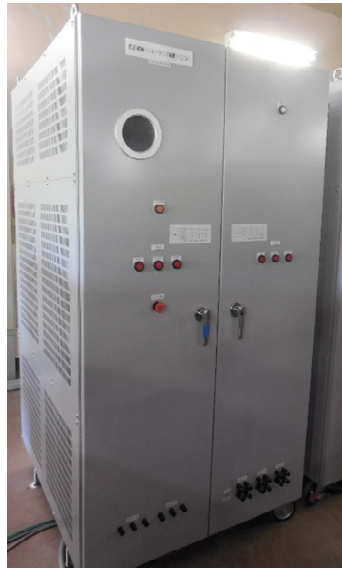
図 5.4(1)-6 配電系統模擬装置
